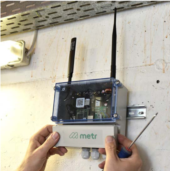
Aufgrund der Größe des Objekts wurden zwei Gateways im Keller und auf dem Dach installiert.
