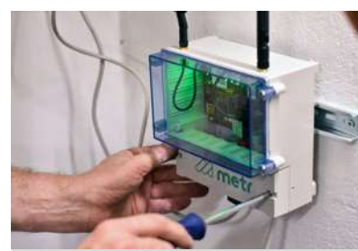
Installation des multifunktionalen IoT-Gateways (m-gate) von metr.
