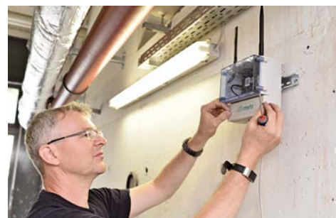
Das IoT-Gateway des Herstellers Metr wird direkt im Heizungskeller installiert
