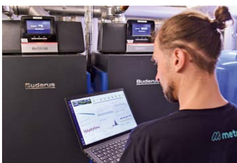
Installation der Lösung für Heizungsanlagen von Metr
